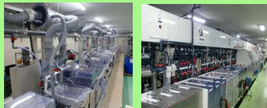
新規開発技術 実験棟ライン Auフープめっき装置ライン
